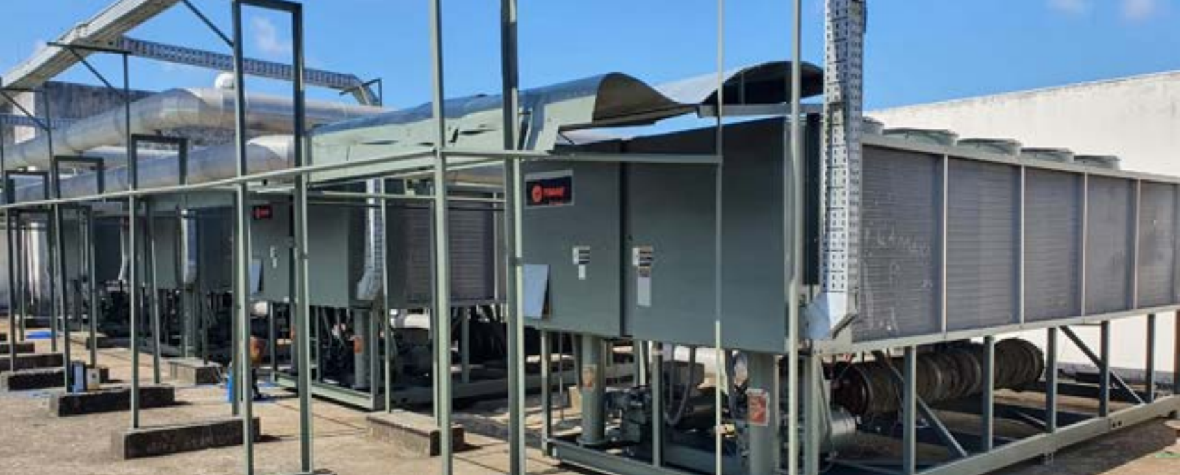
O sistema de ar condicionado central do Fórum Cível da Comarca de João Pessoa passou por manutenção, garantindo qualidade no ambiente de trabalho de magistrados, servidores, colaboradores e usuários daquela unidade.
